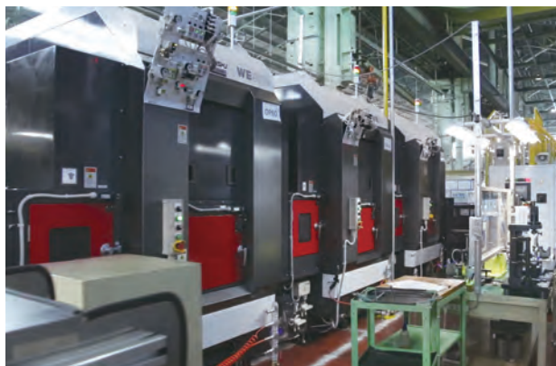
▲新規デフケースE-Loader 自動ライン
